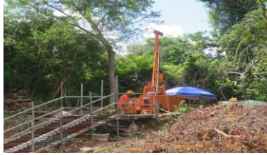
於雞龍灣北進行土地勘探工程 Site investigation works at Kai Lung Wan north
